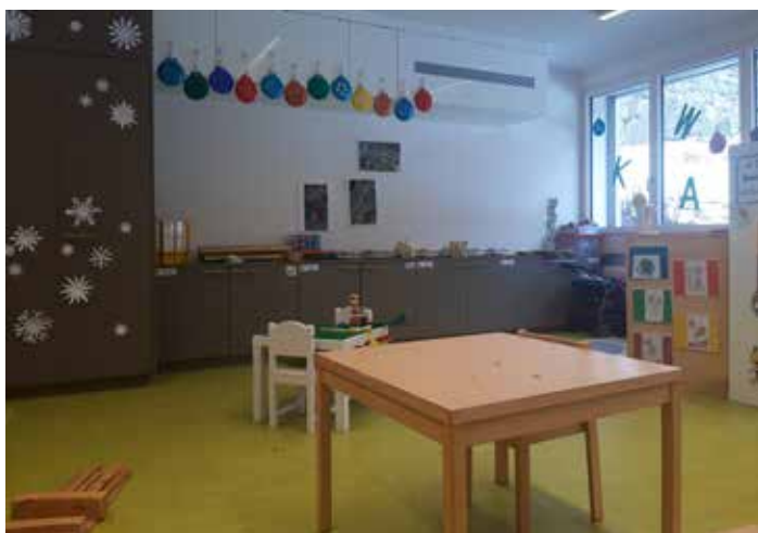
Jardin d'enfants avec unité de ventilation décentralisée. (Photo: FHNW)
